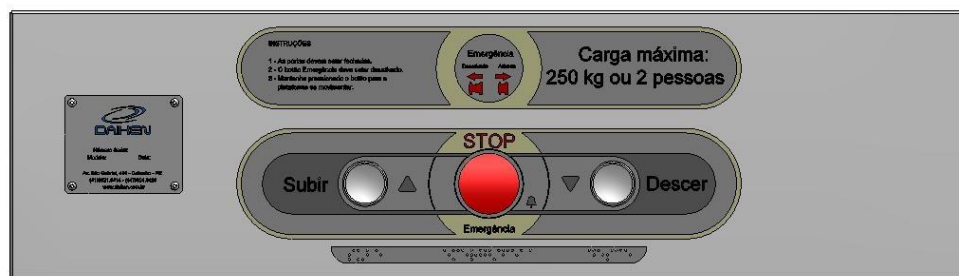
Figura 1 – Painel de comando equipado com botões de pressão.
