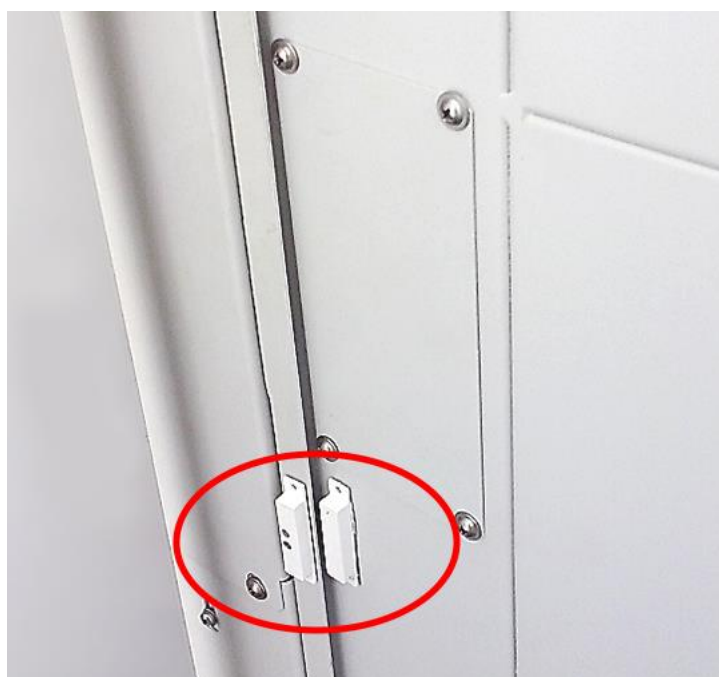
Figura 40: Fixação do sensor magnético na porta grande
